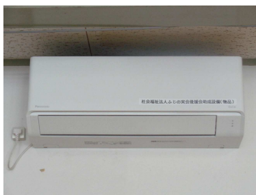
作業室エアコン
